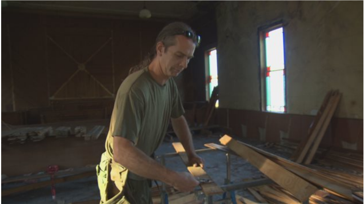
Maxime Robert, en pleine déconstruction de l'église d'Island Brook PHOTO : ICI ESTRIE
