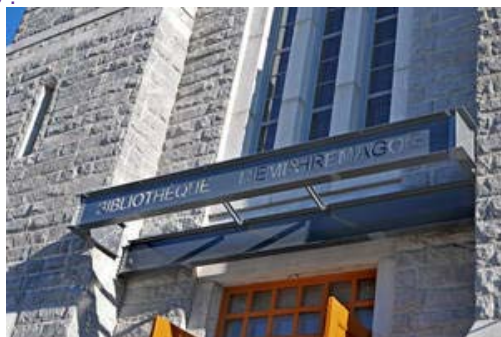
L'église Sainte-Marguerite-Marie de Magog, convertie en bibliothèque Réalisation et photo: Espace vital architecture
